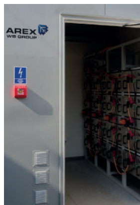
Rys. 7. Wykonany magazyn energii o pojemności 65 kWh wewnątrz zabudowy kontenerowej ładowarki TBC-01
