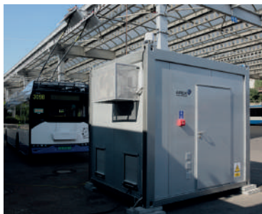
Rys. 2. Układ TBC-01 z zewnątrz w trakcie ładowania trolejbusu (trakcyjnego magazynu energii)
