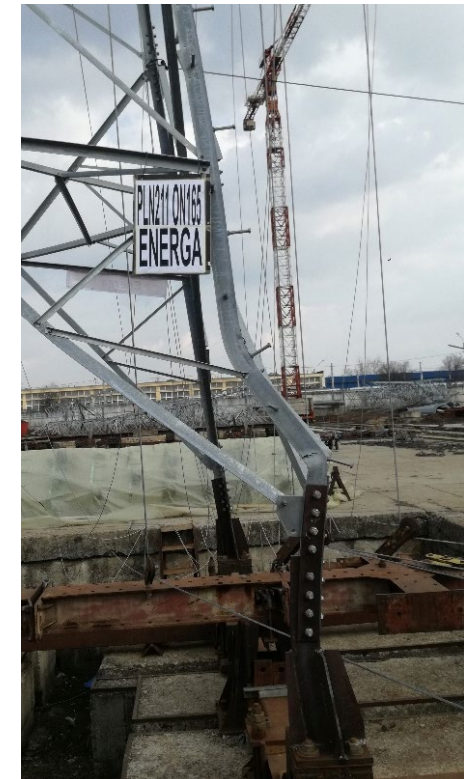
Rys. 4.1.2 Zniszczenie słupa PLN122 ON165
