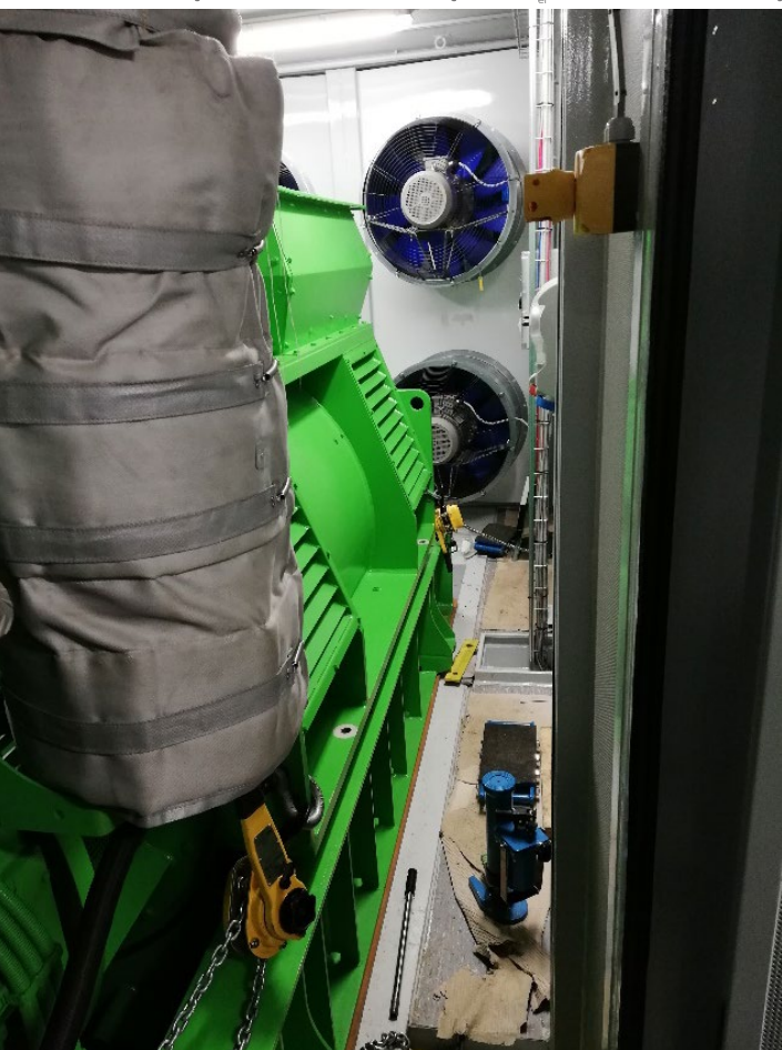
Rys. 2.2 Zabudowa silnika o mocy ok. 3 \text{ MW}_{el} w zabudowie kontenerowej
