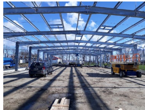
Rys. 2. Konstrukcja nośna magazynu energii
