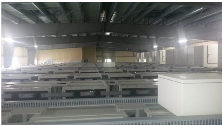
Rys. 6 Przykładowa lokalizacja szaf baterii akumulatorów zrealizowana na podobnej inwestycji. Pomiędzy szafami widoczne są połączenia pomiędzy akumulatorami
