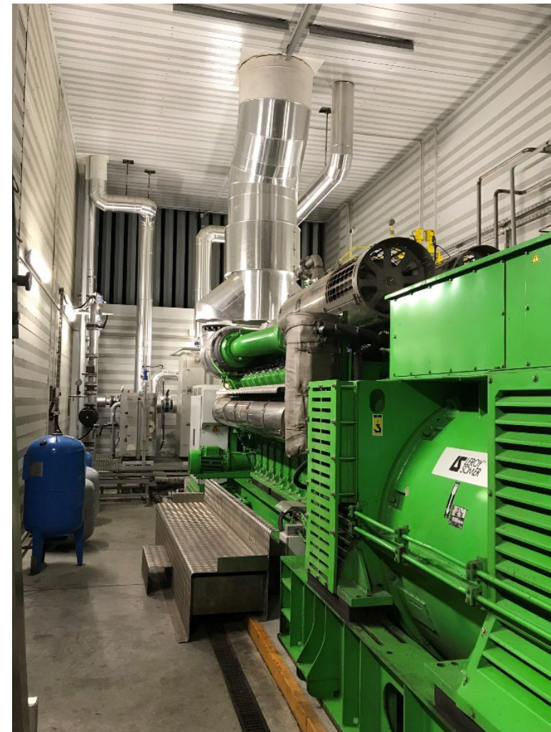
Rys. 2.3 Zabudowa silnika o mocy ok. 3 \text{ MW}_{el} w hali o konstrukcji lekkiej
