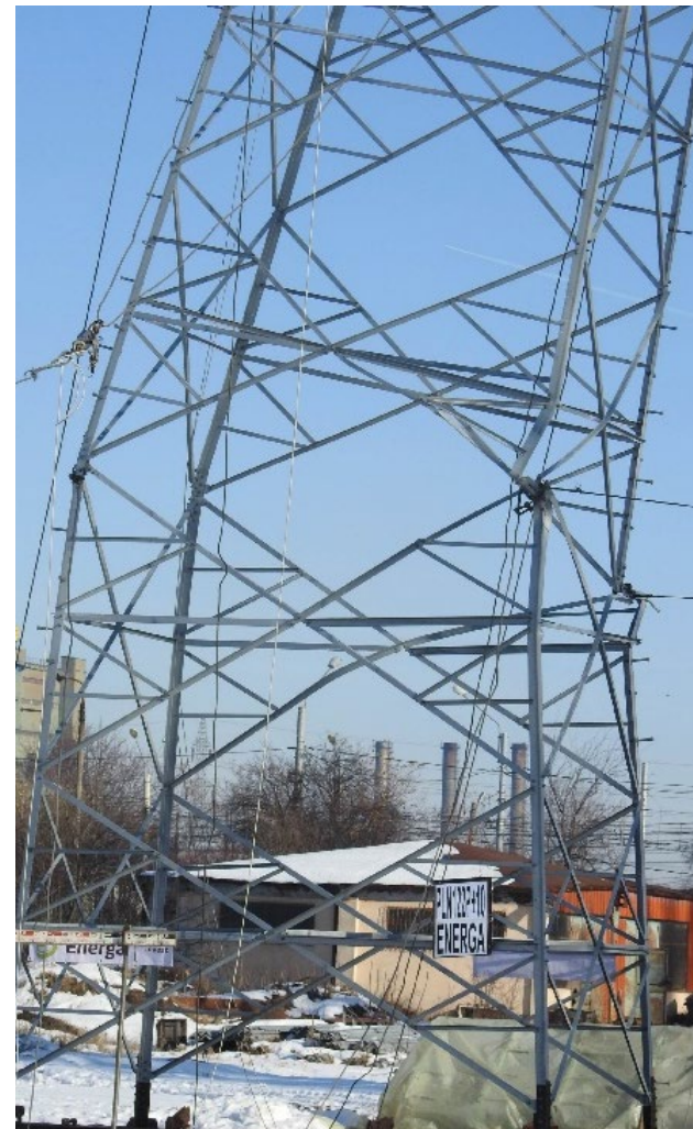
Rys. 4.1.1 Zniszczenie słupa PLN122 P
